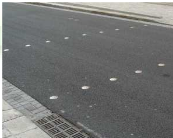
Clous sur passage Piéton Enrobé grenailé
